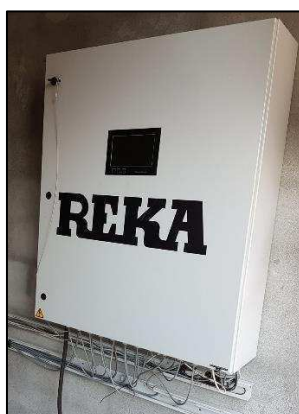
Figure 14 : Modèle tableau électrique de contrôle commande
